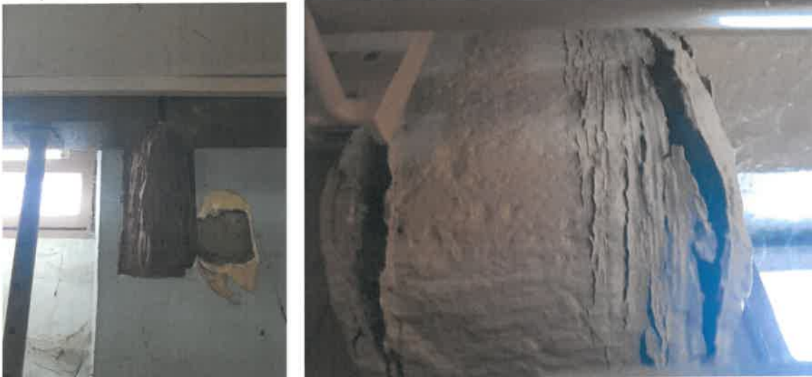
Corbeaux en pierre s'effritant en feuillets – Pérennité structurelle
