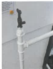
Ancien purgeur d'air en point haut
