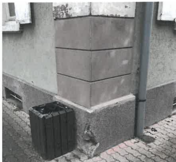
Pierre d'angle de soubassement dégradé à reconstituer
