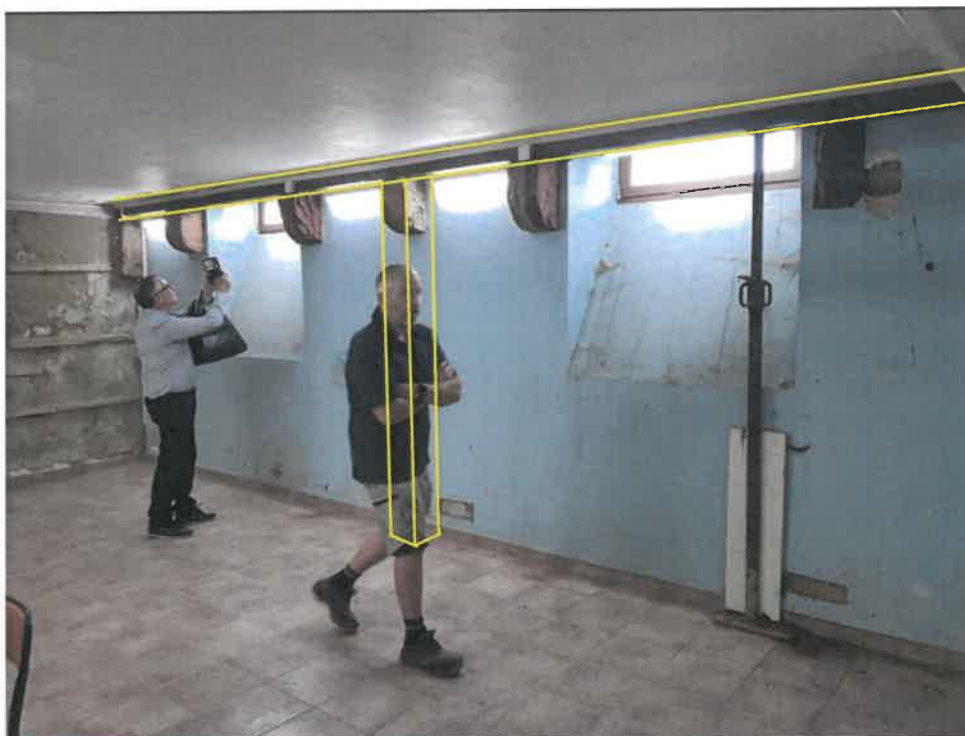
Mise en place d'une structure de type poteau poutre en lieu et place des corbeaux existants
