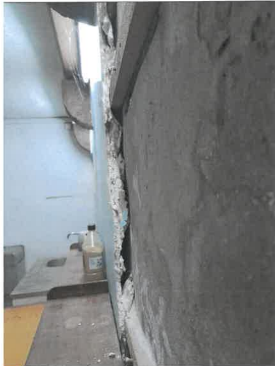
Doublage plâtre existant retenant l'humidité – sous-sol
