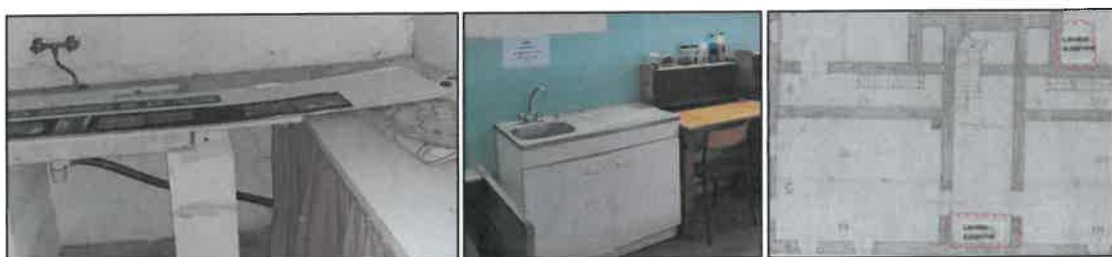
Lavabos sur puit perdu
